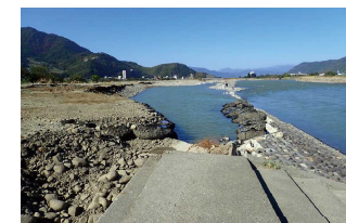
被災状況：千曲川護岸
